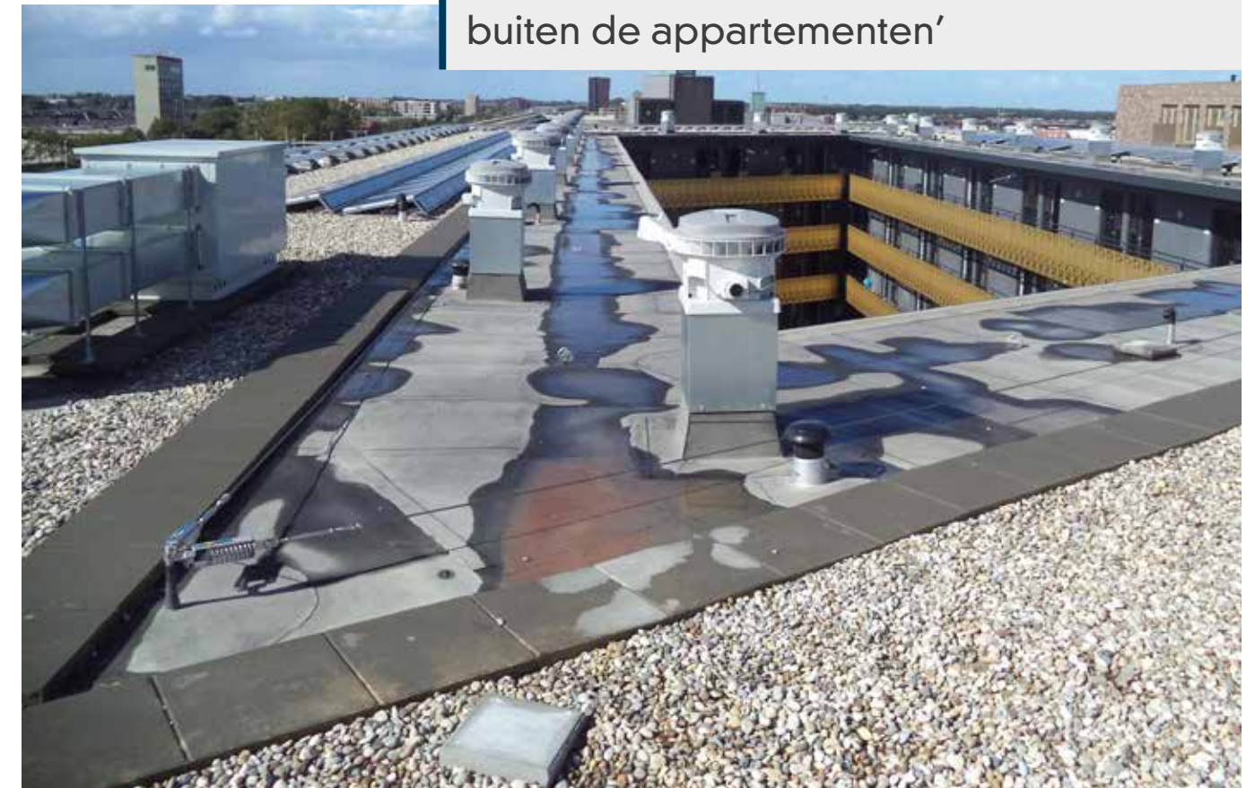
De ventilatie wordt collectief geregeld via drukgergelde dakventilatoren.
